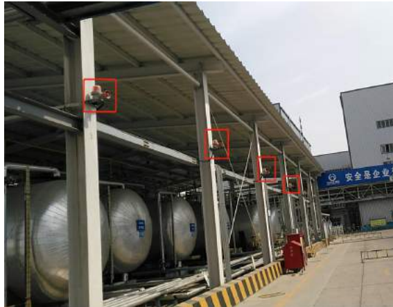
罐区泄漏报警装置
