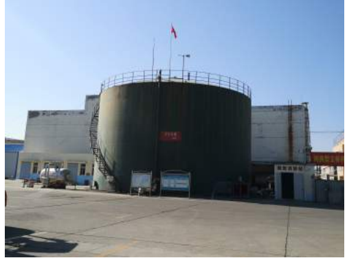
南厂区消防水罐
