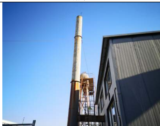
导热油炉废气排气筒
