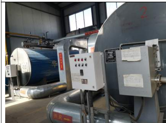
南厂区导热油炉房
